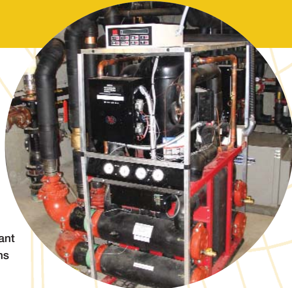
Pompe à chaleur pour un système hybride solaire-géothermique.
