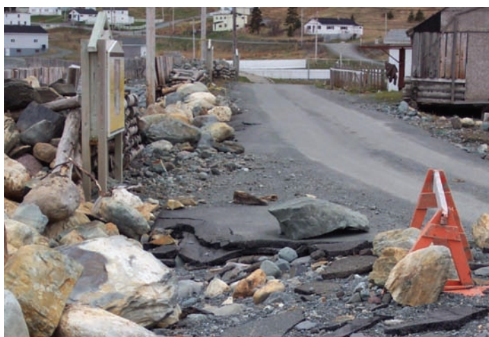
FIGURE 27 : Route endommagée par une onde de tempête en avril 2004, à Ferryland (Terre-Neuve-et-Labrador).
