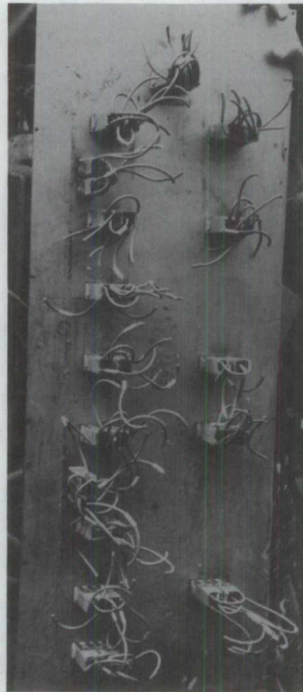
PHOTOGRAPHIE 7 Vue du dessous du panneau schématique des soupapes des réservoirs (bâbord).
