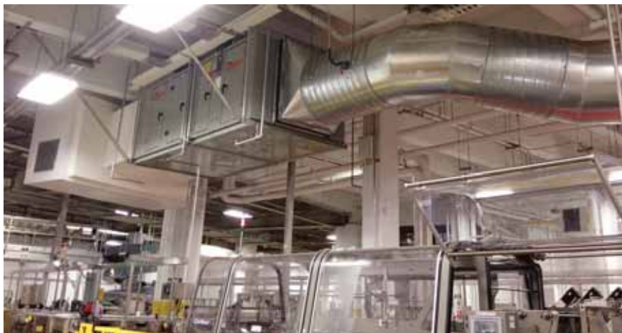
L'une des 3 centrales d'air avec boîte de mélange qui récupèrent la chaleur de l'air au plafond de l'usine.
