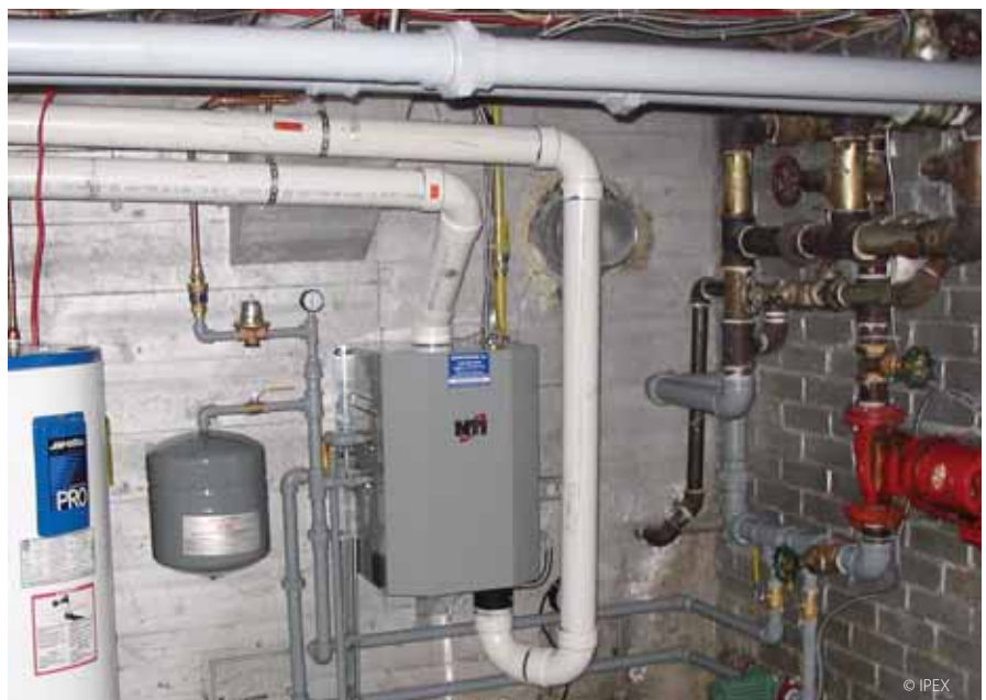
Conduits d'amenée d'air et d'évacuation en PVC.
