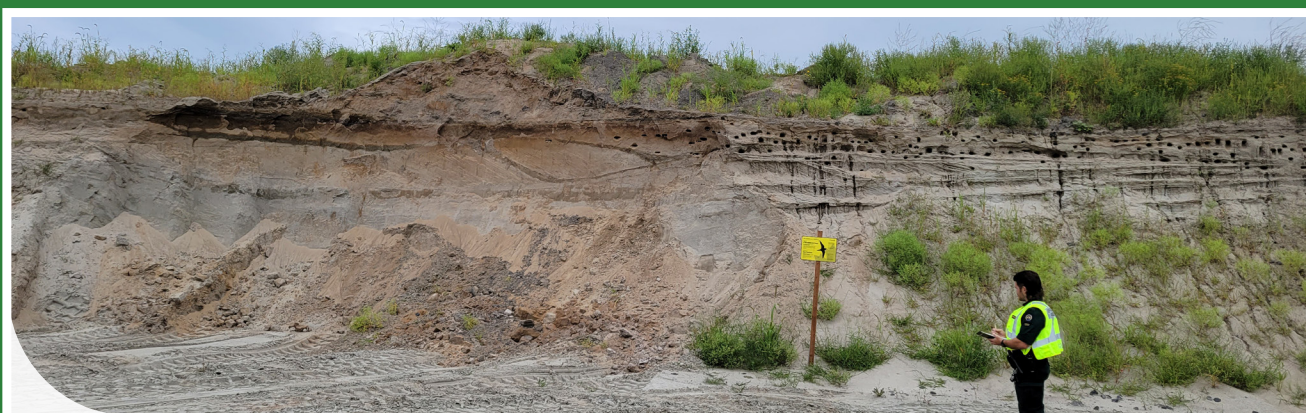
Excavation qui a détruit des nids d'hirondelles de rivage. Photo : ECCC
